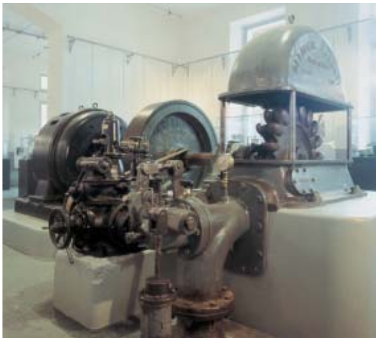
Wasserkraftwerk Serso in Pergine
