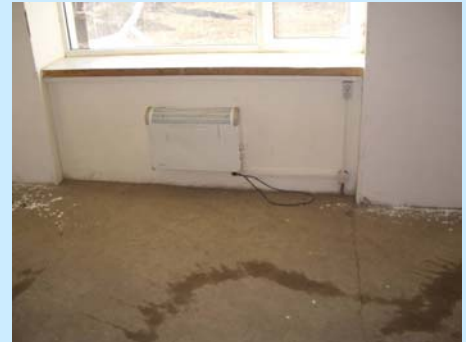
Maison mal isolée avec radiateur électrique
