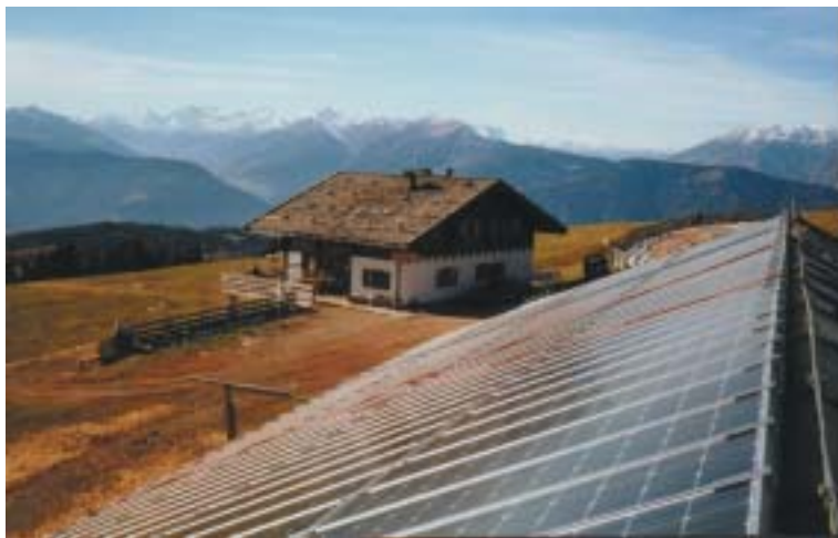
Impianto fotovoltaico alla Vöraner Alm
